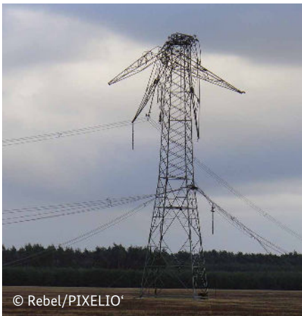
Sturmschaden durch den Orkan Kyrill im Jahr 2007
